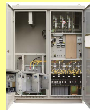
高圧受電設備
